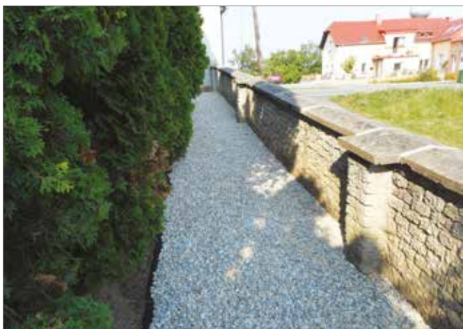
V červenci byla provedena oprava hlavy zděné zídky, odebrání navezené zeminy, položení folie a zašterkování.
