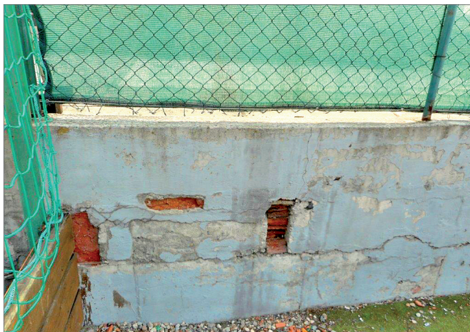
Opěrná zídka na hřišti za kulturním domem už dosloužila!? I ze zápisu revizní technika o kontrole stavu sportoviště z letošního března vyplývá nutnost její opravy.
