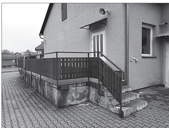
Snad se v letošním roce najdou prostředky na opravu vstupního schodiště do kulturního domu a hlavně terasy za KD, která svým vzhledem a stavem „přijímá“ posezení na zahrádce místní restaurace.
